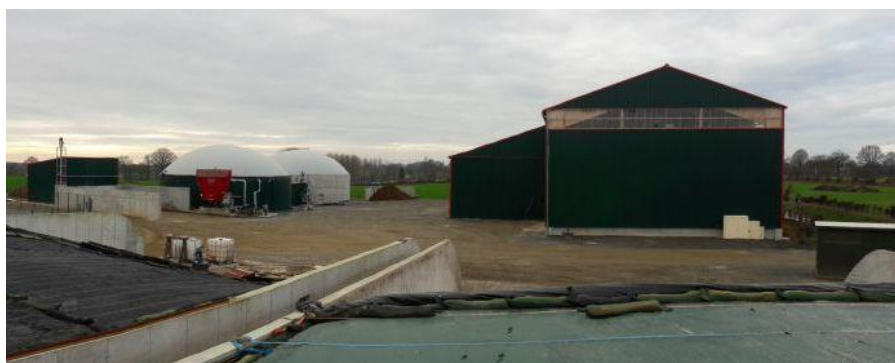
La centrale de méthanisation et le hall pour la nouvelle installation automatisée de séchage. Photo: France Biogaz
